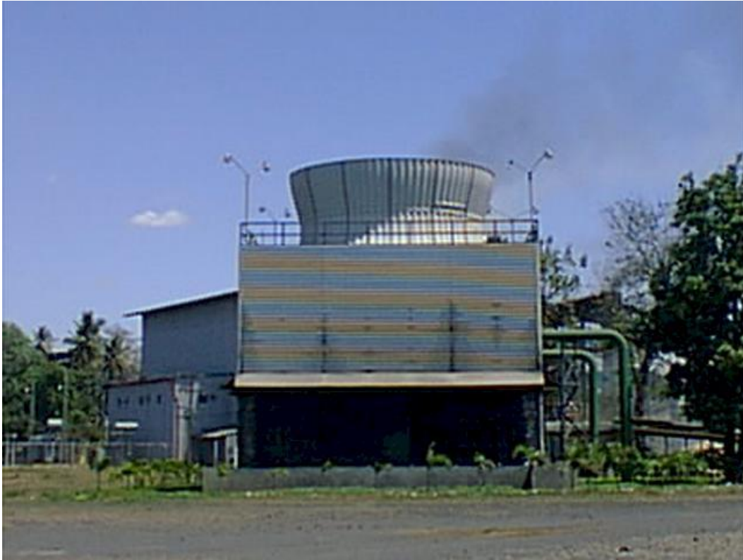
Torre de Enfriamiento
