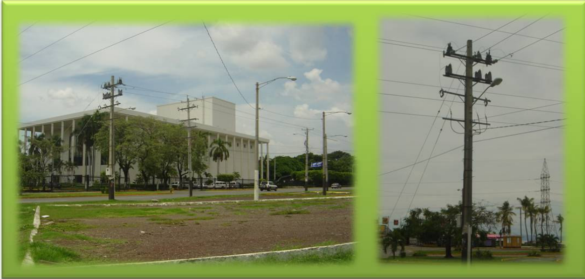
Ilustración 28 Sistema de Alumbrado Público y Energía Eléctrica Fuente: Propia
