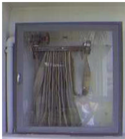
Manguera contra incendios
