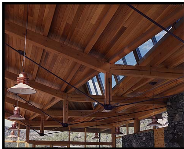
Foto No. 25: Detalle de Estructura de techo de Comedor, Campamento Paint Rock.
