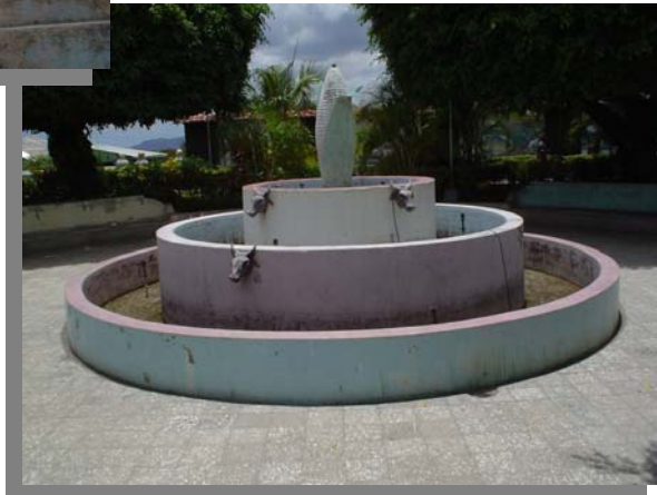
Foto N° 13: Fuente de agua existente en el restaurante
