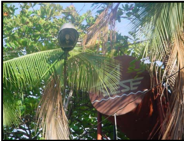
Foto N° 34. Instalaciones Eléctricas e Iluminarias.
