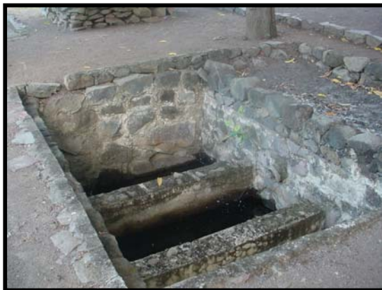
Foto N°32. Tratamiento de Aguas Pluviales.
